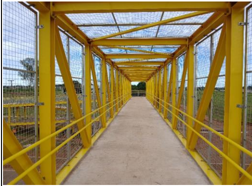
Localização Descrição BR 163/MT KM 839+800 - Sinop Tela de Proteção
